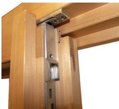
Otvoreni spojevi između prvog i drugog krila slabe su točke
